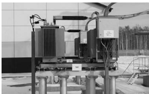
Рис. 11.2. Трансформаторно-преобразовательный блок (ТМП)
